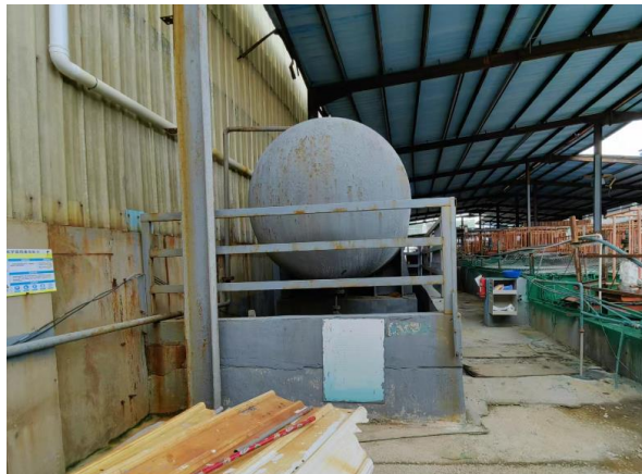
硫酸储罐及围堰
