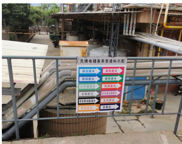
各厂区的废水收集管道
