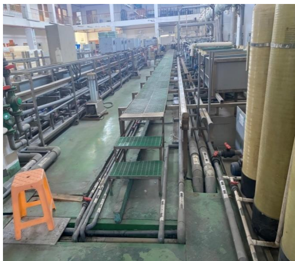
电镀车间污水收集管道
