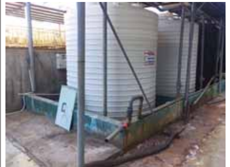
污水站药剂桶周边围堰
