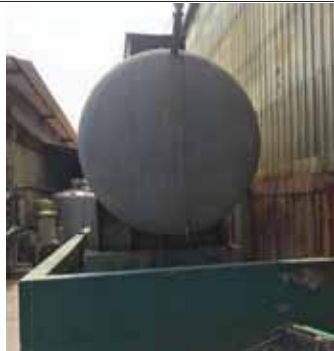
硫酸储罐及围堰
