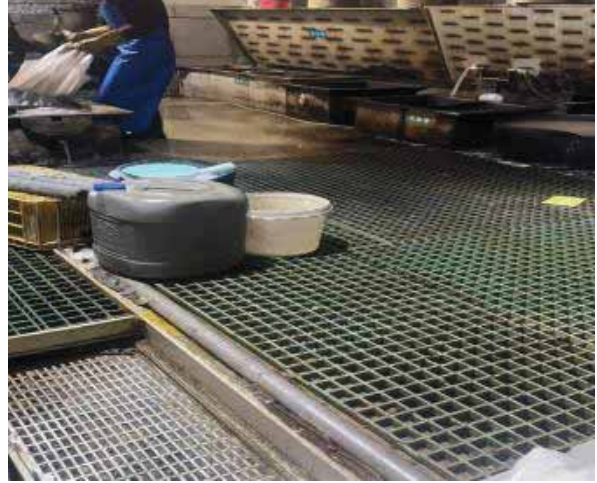
除油区防渗措施 2
