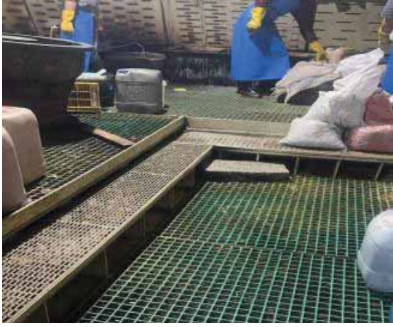
除油区防渗措施 1
