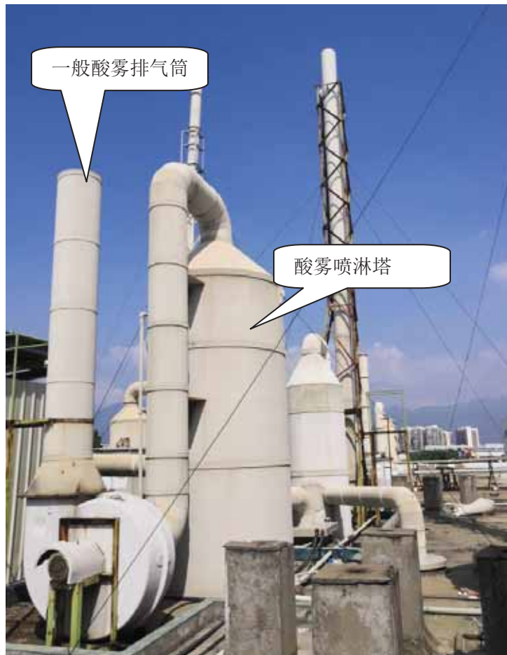
图 3.6.3 废气治理设施
