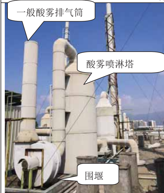
废气处理设施
