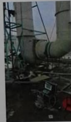
酸雾喷淋塔废气出口
