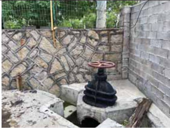
先锋 11# 厂房雨水排放口应急阀门
