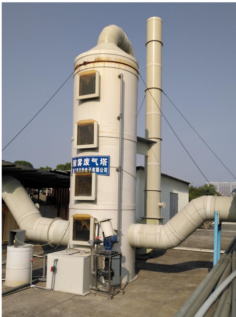
图 10.1-11 废气治理设施
