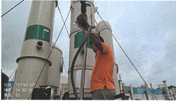
铬酸雾废气排气筒 FQ-002 出口(点位:◎1)
