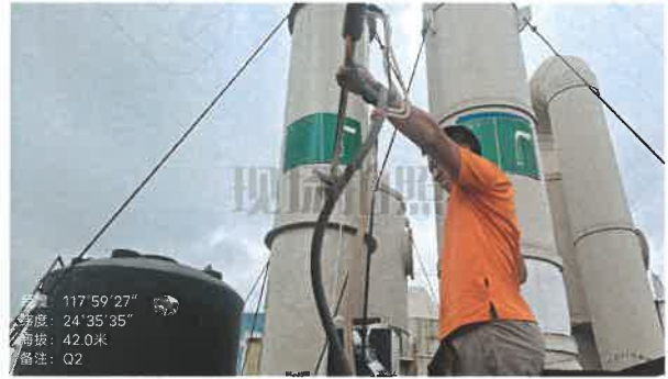
盐酸雾废气排气筒 DA002 出口(点位:◎2)
