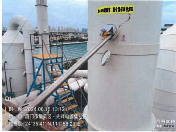
DA001 酸雾废气排放口出口(点位:◎1)
