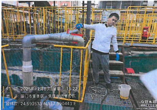
DW004 含铬废水排放口进口
