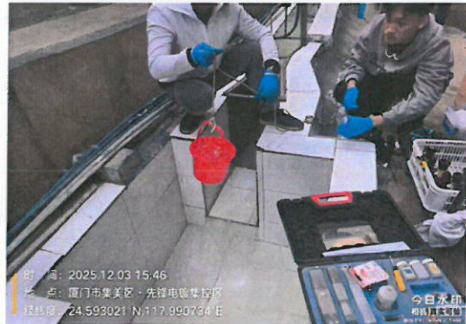
油脂处理设施出口
