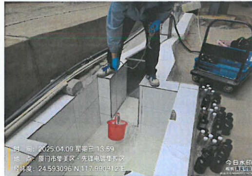
油脂处理设施出口
