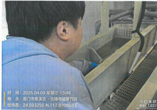
铬系处理设施出口
