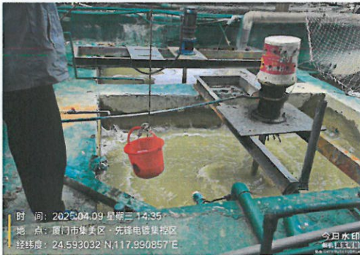
油脂处理设施进口
