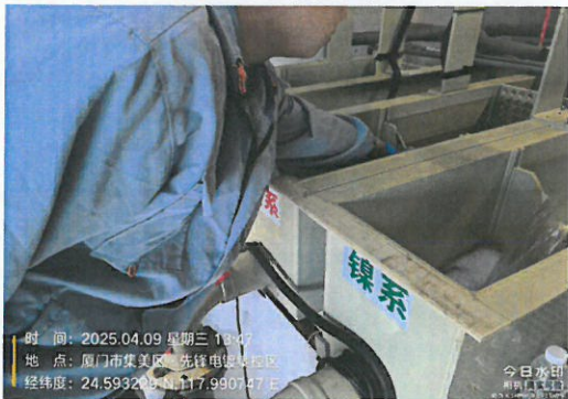
氰系处理设施出口
