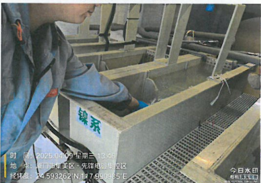
镍系处理设施出口
