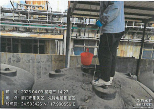
氰系处理设施进口
