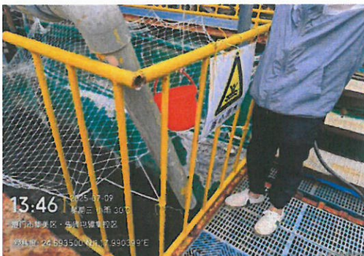
DW004 含铬废水排放口进口
