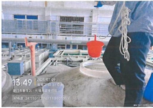
DW001 含镍废水排放口进口
