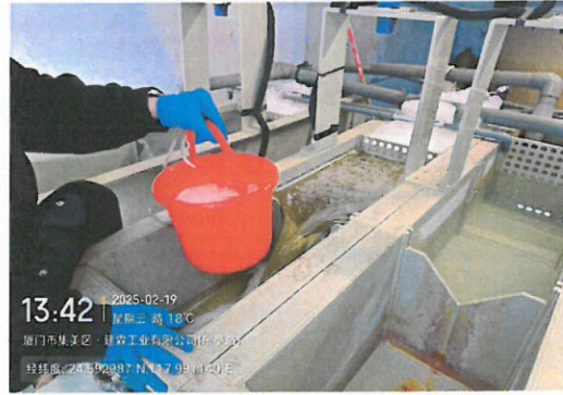
氰系处理设施出口
