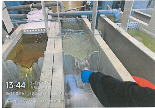
镍系处理设施出口
