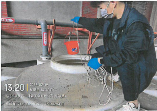
氰系处理设施进口
